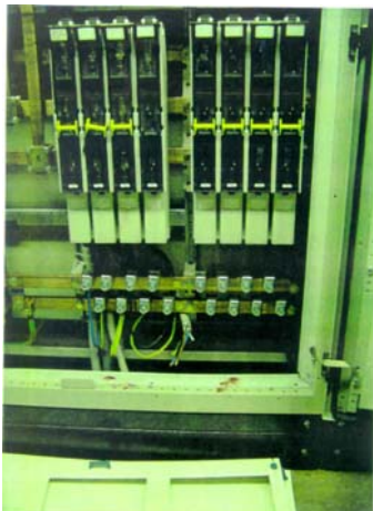
Bild: Der Monteur beugte sich in den Schaltschrank und erlitt einen Stromschlag.
